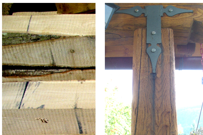
Figura 2: Il contatto tra il castagno allo stato fresco e un elemento metallico ferroso porta alla formazione di macchie nere superficiali sul legno (a sinistra). L'azione dell'acqua piovana, dati i tannini idrosolubili, può comportare colature di colore scuro dagli elementi di acciaio (a destra).
